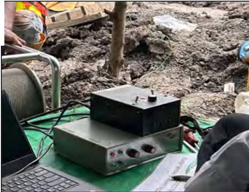
Gambar 20 Receiver dan Speed Control untuk menangkap data pantulan Gamma dan mengatur kecepatan winch cable
