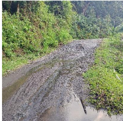
Gambar 9. Kondisi jalan di beberapa titik yang belum mempunyai saluran drainase
