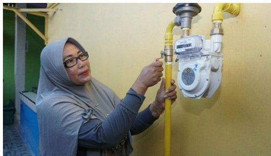
Gambar 2. 3 Infrastruktur Jaringan Gas Rumah Tangga (Jargas) Kab. Wajo (Sumber : Decimal News, 2025)
