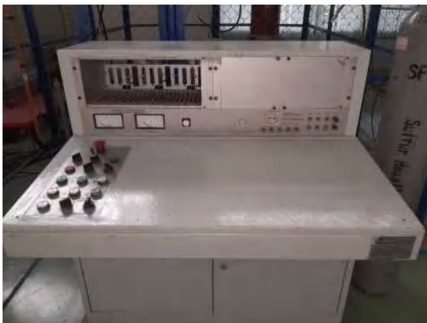
Gambar 12 Meja Kontrol Pengujian Tegangan Tinggi
