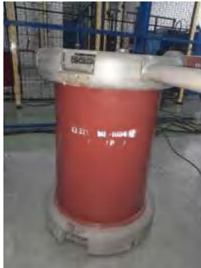
Gambar 11 Trafo Pengujian Tegangan Tinggi
