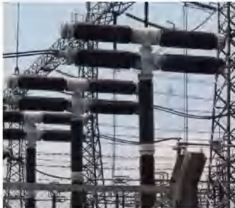
Gambar 2. Pemutus tenaga tegangan tinggi dengan SF 6 Sumber: Suripto S., 2017
