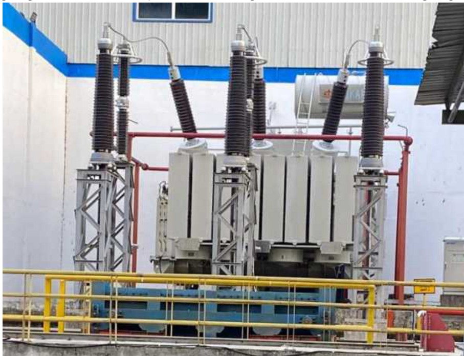
Gambar 8. Transformator Sumber : PLTA Malea
