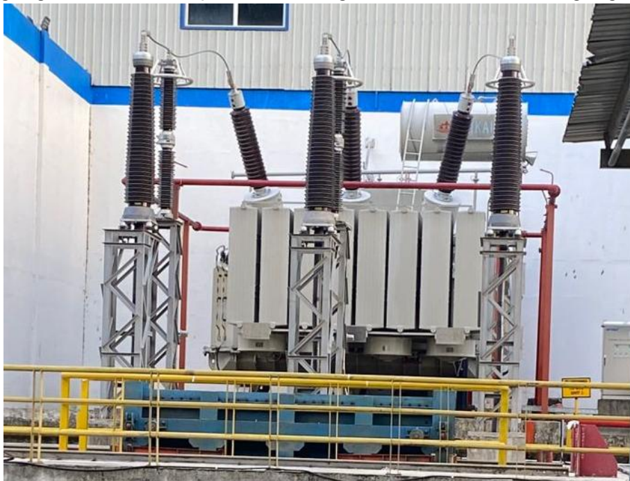
Gambar 8. Transformator Sumber : PLTA Malea
