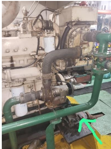
Gambar 6. Pipa pada kapal
