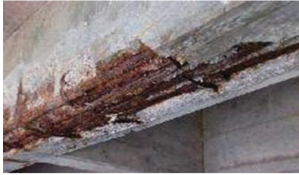
Gambar 1.2. Spalling pada beton bertulang akibat korosi
