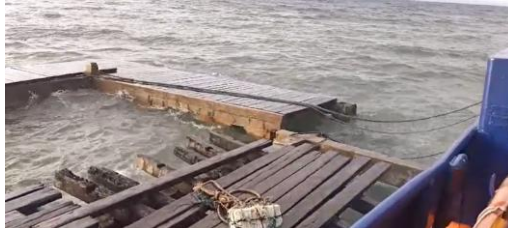
Gambar 1.1. kondisi infrastruktur pelabuhan yang sudah rusak
