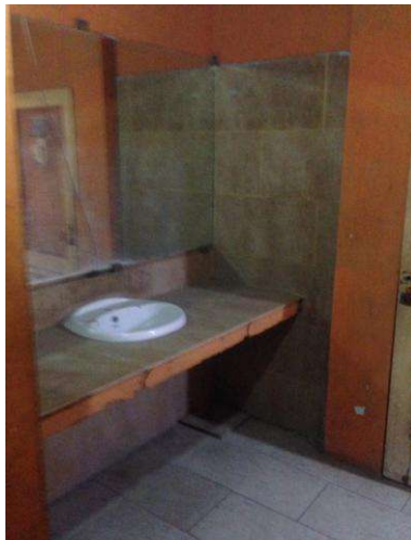
Gambar 54. Kondisi Wastafel di Toilet Pria
