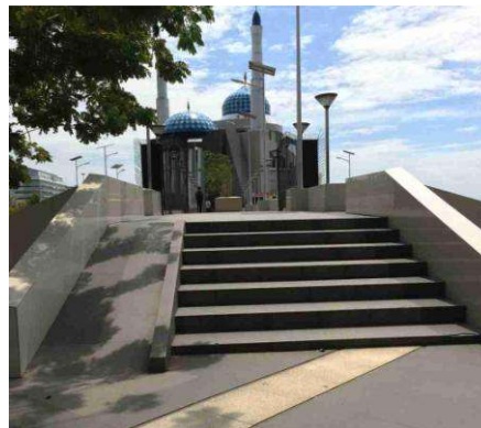
Gambar 72. Kondisi ram (B 5) dan tangga (C 10) pada segmen C
