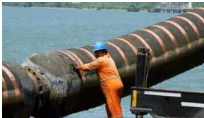
Gambar 1.4 Kebocoran pipa bawah laut
