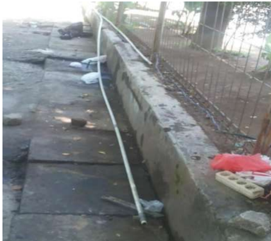
Gambar 9. Fasilitas Instalasi Listrik dan Air Bersih (sumber: dokumentasi peneliti)
