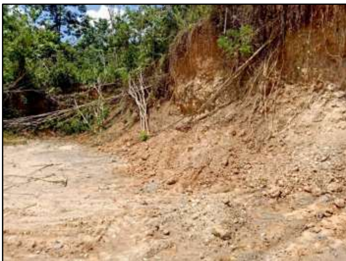
Gambar 12 Debris fall di daerah Simbune sekitar stasiun 12 dengan arah foto N 24°E
