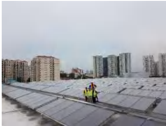
Gambar 4. Instalasi panel surya pada IKEA Alexandra sumber: https://www.solid.at/wp-content/uploads/2023/08/7530.10E.20171023_IKEA-Kollektorflaeche-scaled.jpg
