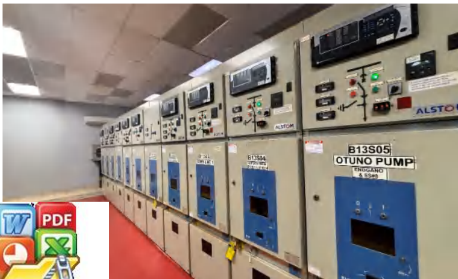
Gambar 6 Switchgear pada Gardu Hubung
