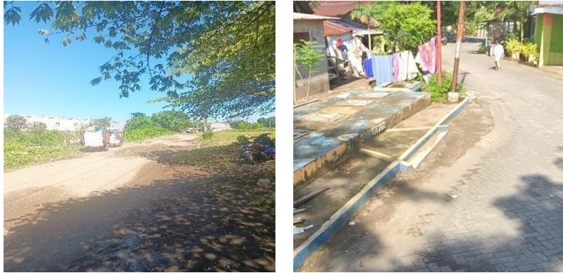
Gambar 2. 5 Kondisi Jalan di Kelurahan Tanjung Merdeka
