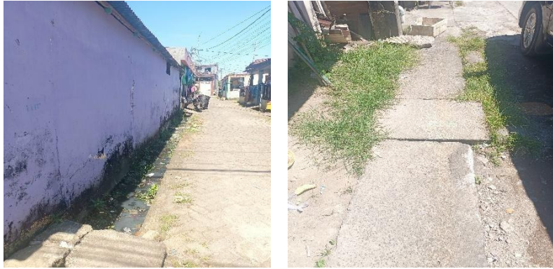
Gambar 2. 11 Kondisi Drainase Lingkungan Kelurahan Tallo
