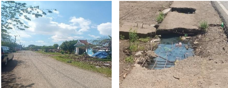
Gambar 2. 12 Kondisi Drainase Lingkungan Kelurahan Tanjung Merdeka
