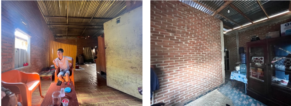
gambar 2.4 kondisi rumah penerima bantuan bps yang belum diplester akibat keterbatasan kemampuan ekonomi (sumber: dokumentasi peneliti, 2025)
