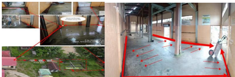
Gambar 1. Hasil observasi proses aliran air limbah menuju saluran pembuangan, alur aliran air limbah menuju IPAL dan kondisi IPAL (Herman et al. , 2023)
