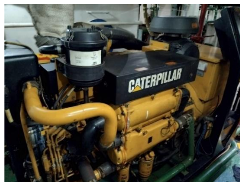
Gambar 1. Auxiliary engine Kapal Sumber : Hasil Dokumentasi Lapangan
