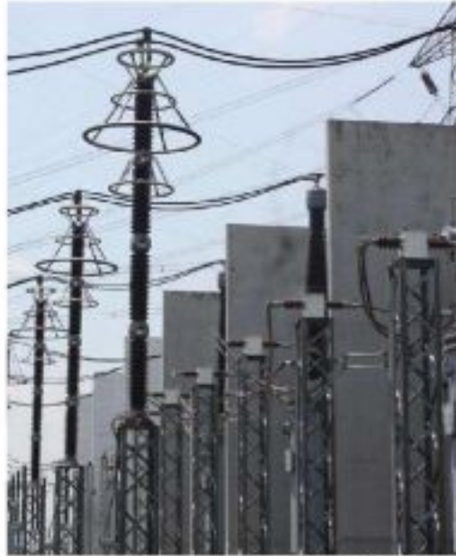
Gambar 4. Lightning Arrester untuk melindungi trafo daya Sumber: Sripto S., 2017
