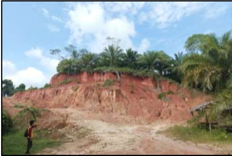
Gambar 11 Kenampakan residual soil hasil pelapukan batuan Granit dengan ketebalan sekitar 5 – 10 meter pada stasiun 5 arah foto N21°E
