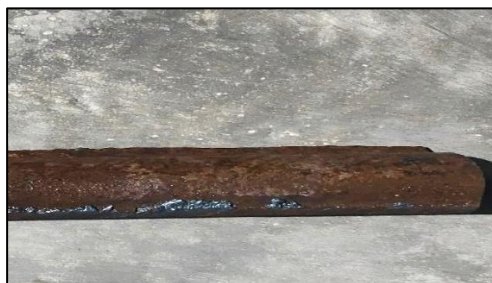
Gambar 2. Waterwall Tube Setelah 11 Tahun Pengoperasian
