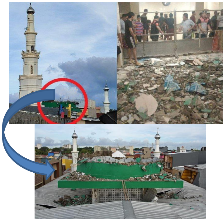
Gambar 1. Kondisi kubah Masjid Ittifaqul Jamaah yang roboh
