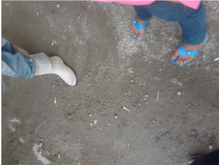
Kondisi tanah di depan gudang yang mengeras
