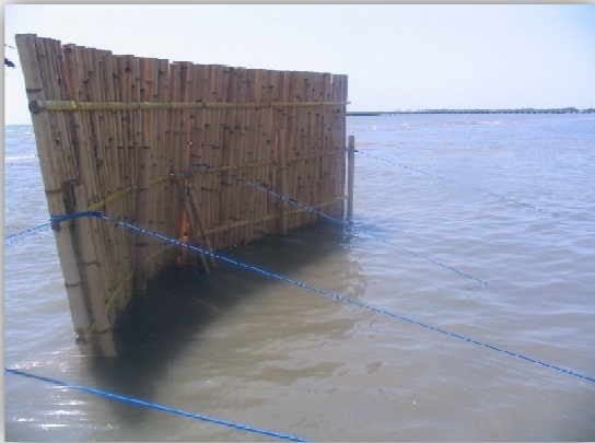
APO pancang yang digunakan awal Penelitian (tidak mampu menahan gelombang) diganti dengan gambar kanan
