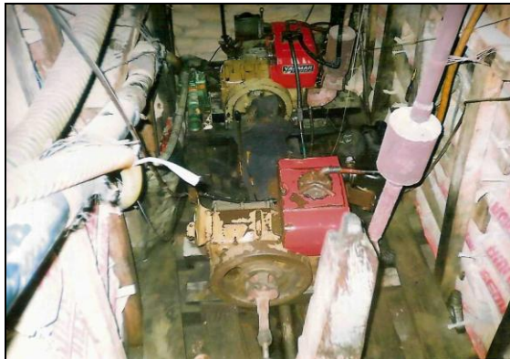
Gambar 9. Kamar Mesin Kapal Pinisi 100 GT (tidak kedap)
