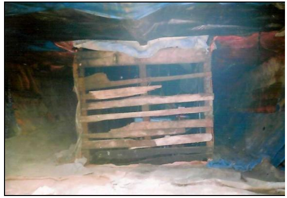
Gambar 10. Kamar Mesin Kapal Pinisi 35 GT (tidak kedap)
