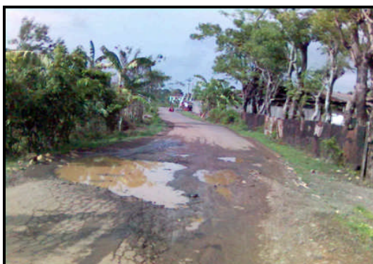
Kondisi ruas Jalan Katimbang (pos pengamatan keempat)
