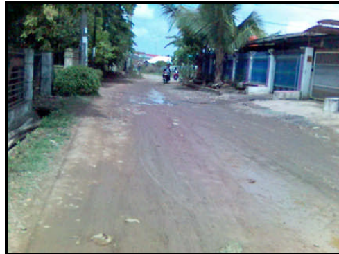
Kondisi ruas Jalan Kebahagiaan Utara (pos pengamatan kedua)
