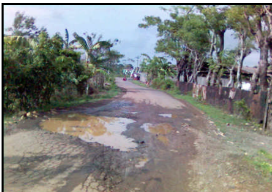
Kondisi ruas Jalan Katimbang (pos pengamatan keempat)
