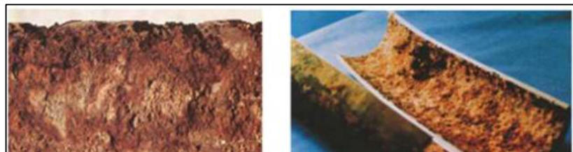
Gambar 10 Korosi seragam pada pipa (Dewi, et al., 2022)
