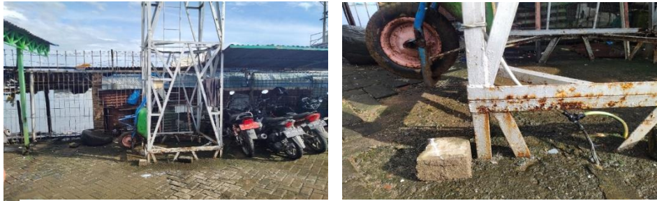
Gambar 1. Korosi pada baja
