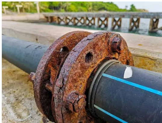
Gambar 3. Korosi akibat pengaruh lingkungan pesisir
