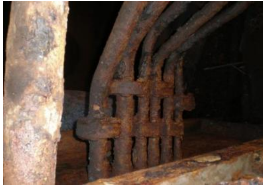
Gambar 6. Korosi seragam pada pipa ballast
