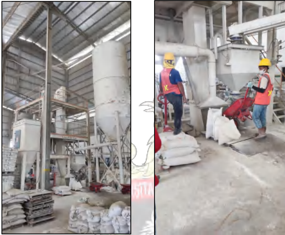
Lampiran 4 Stasiun kerja loading & mixer
