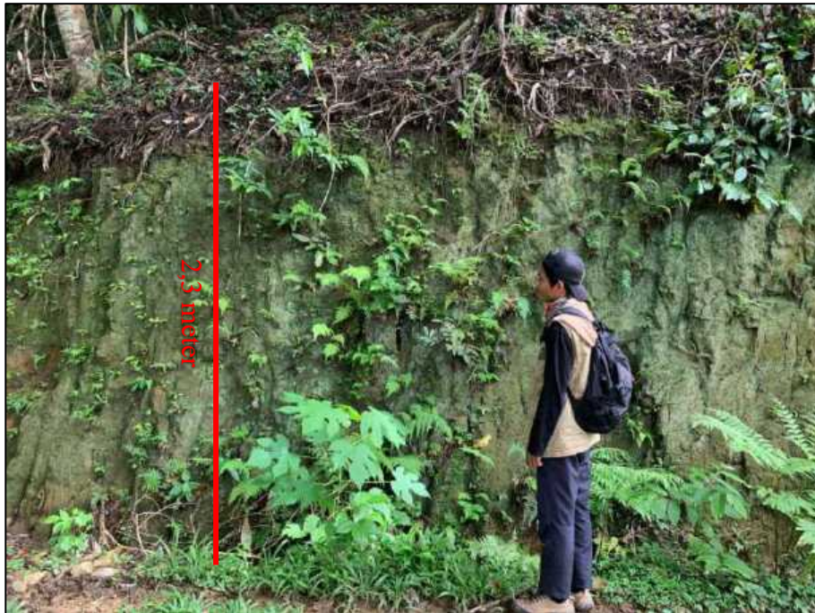
Foto 2.6 Pelapukan berupada residual soil pada litologi batugamping sekitar stasiun 12 Daerah Sabila, arah foto N 140° E.
