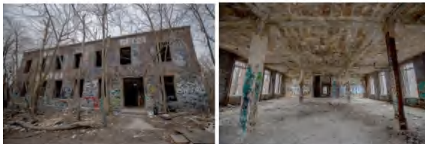
Gambar 7 Urban cracks perkotaan (Sumber: Barliana, 2020)
