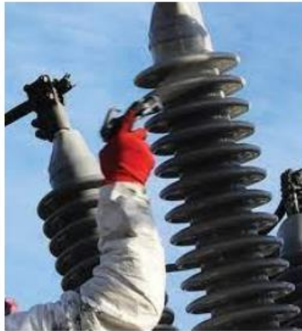
Gambar 6. Lapisan RTV digunakan pada sebuah bushing trafo 230 kV
