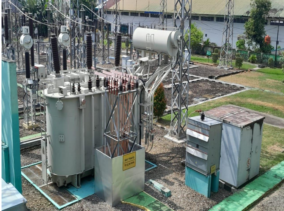
Lampiran 3 Bay Trafo #2 GI Panakkukang
