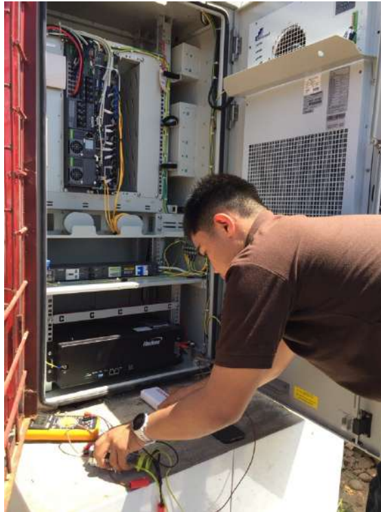
Gambar 2 Monitoring Perangkat OLT
