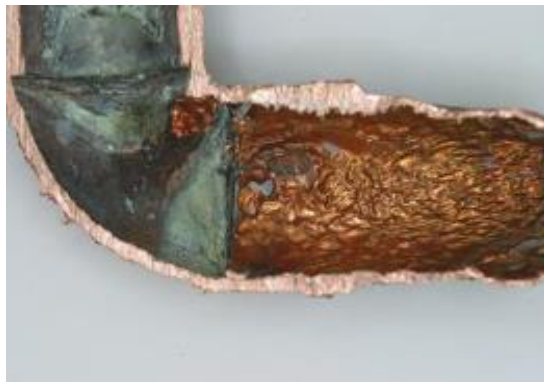
Gambar 3 Errosion corrosion (korosi erosi) (Sumber: B. Utomo, 2012)
