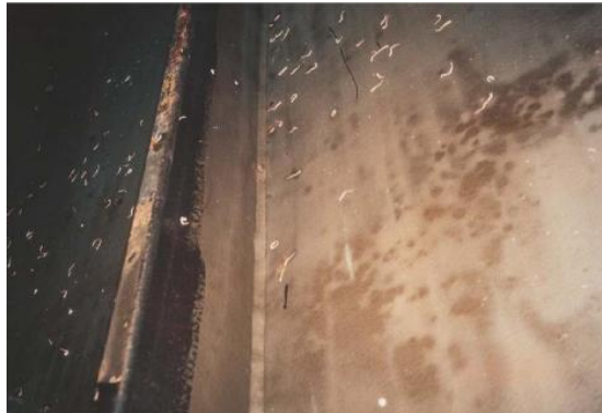
Gambar 7 Korosi mikrobiologi (Sumber: B. Utomo, 2012)
