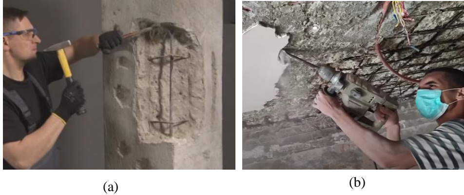
Gambar 9. (a) Chipping pada kolom, (b) Chipping beton pada struktur overhead
