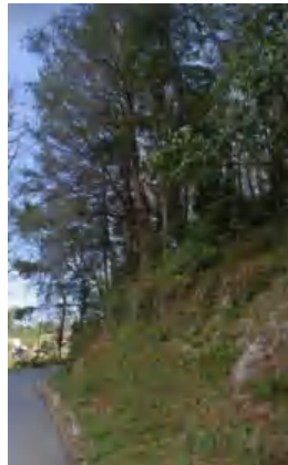
(a) Lokasi kejadian longsor TL2 pada tahun 2023
