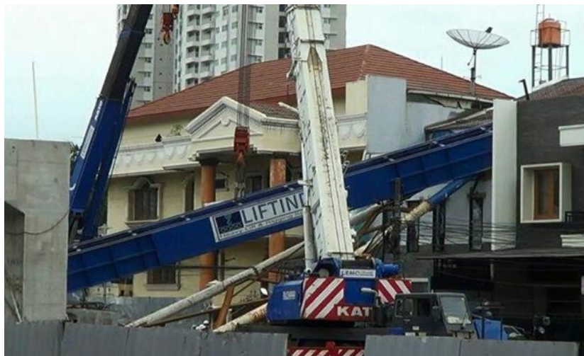
Gambar 2.5. Ambruknya Jembatan Tol Bocimi
