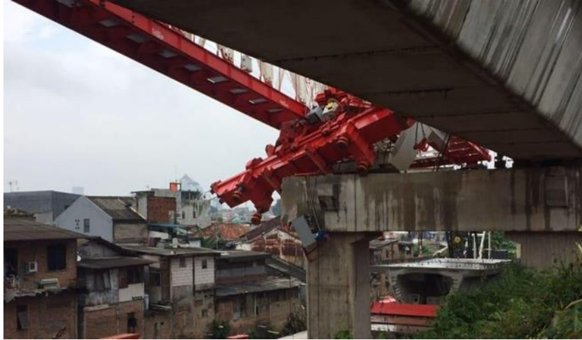
Gambar 2.3. Jatuhnya Crane Proyek Kereta Api DDT Mataram
