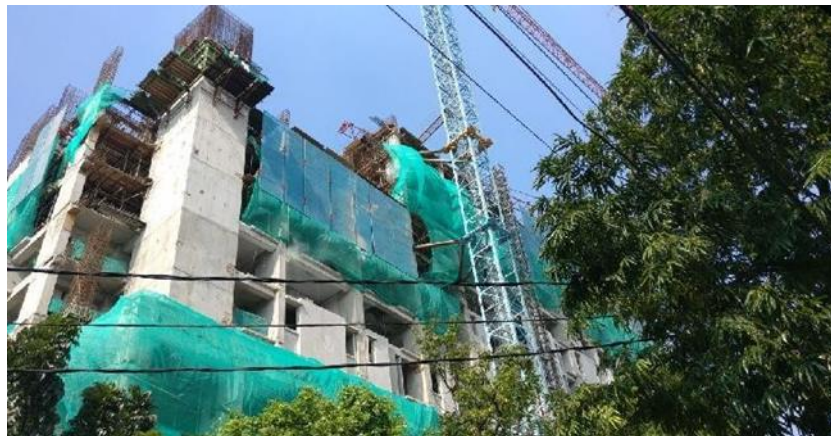
Gambar 2.2. Jatuhnya Besi Hollow Proyek Rusun Pasar Rumput
