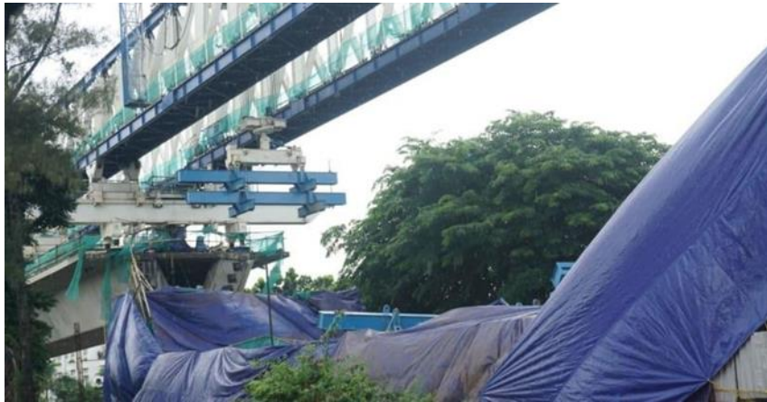
Gambar 2.4. Ambruknya LRT Kayu Putih Jakarta
