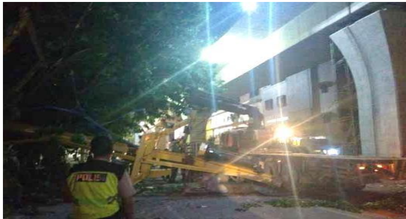
Gambar 2.1. Jatuhnya Crane Proyek Jalur Layang Kereta Api Medan
