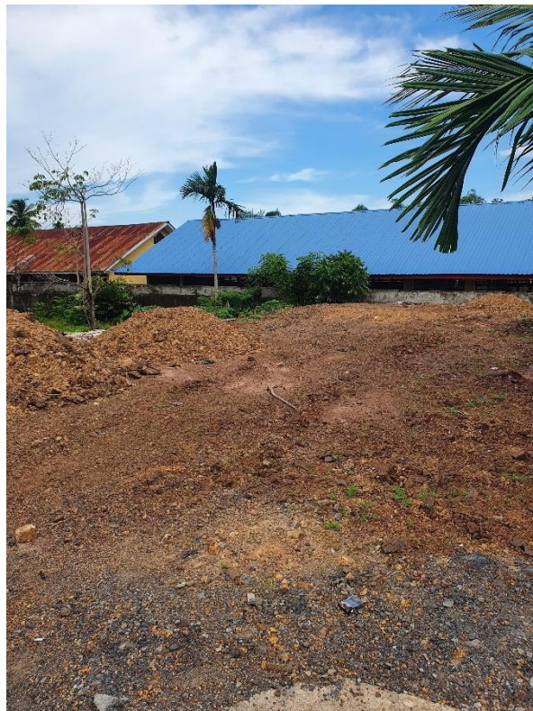
Gambar 19. Bekas Kejadian Longsor di DAS Lamasi
