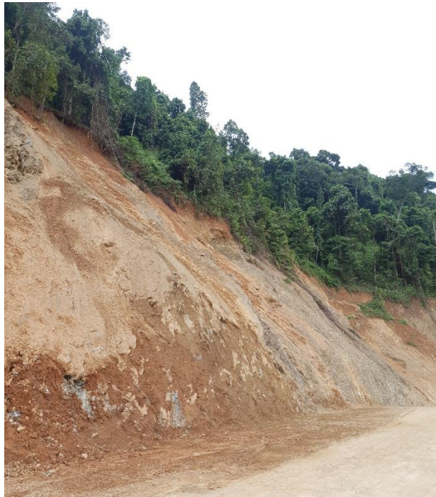
Gambar 17. Bekas Kejadian Longsor di DAS Lamasi
