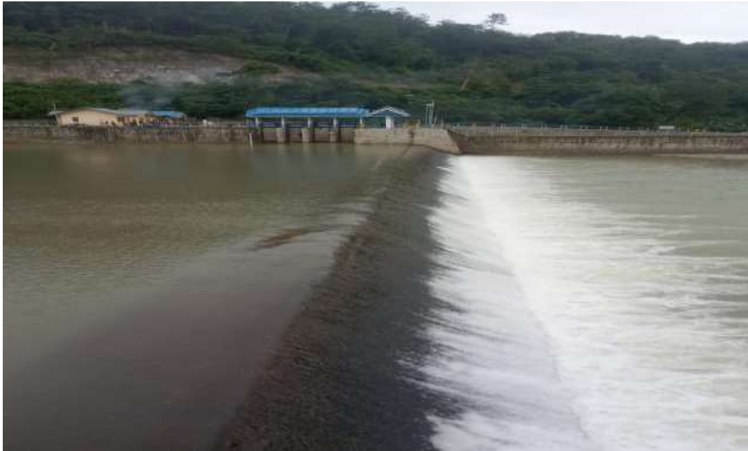
Gambar 5. Bendung Tomatoppe Desa Rumaju Kecamatan Bajo Kabupaten Luwu
