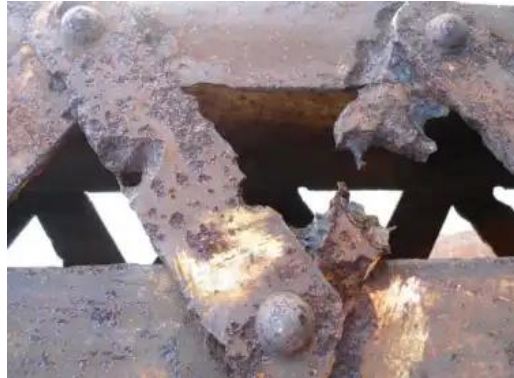
Gambar 2.6 Korosi Sumuran (Sumber : theconstructor.org)
