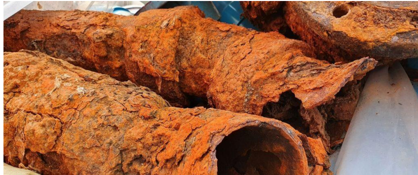
Gambar 2.8 Korosi Erosi (Sumber : chemindo.com)
