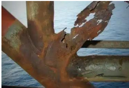
Gambar 2.4 Korosi Lelah (Sumber : theconstructor.org)
