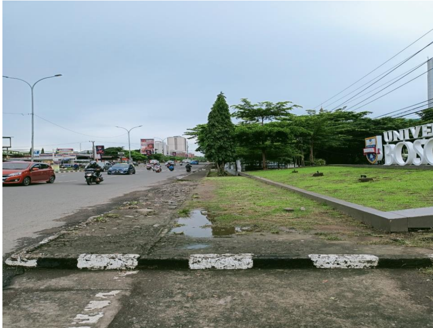
Gambar 6. Jalur Pedestrian Titik Depan UNIBOS Jl. Urip Sumoharjo Yang Mengalami Kerusakan.
