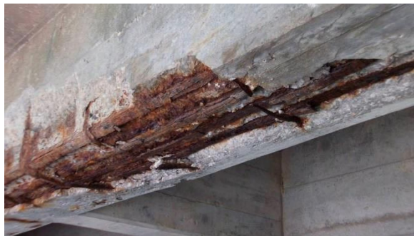
Gambar 1. Kerusakan pada beton akibat korosi tulangan baja
