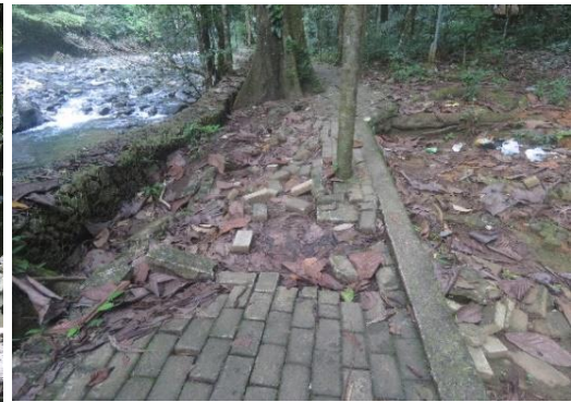
Kondisi Jalan menuju Camping Ground
