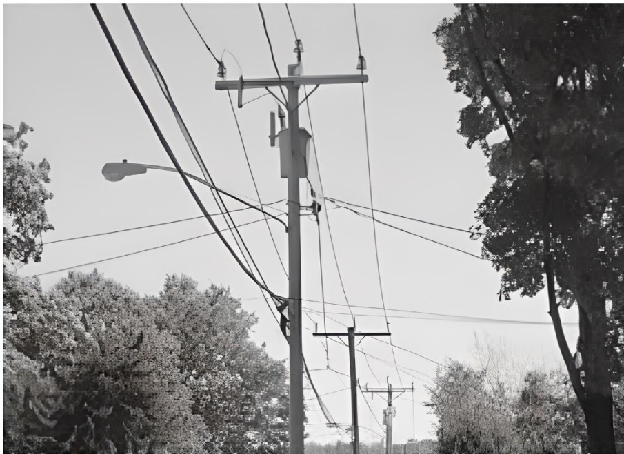
Gambar 2.7 Saluran Udara Tegangan Menengah (SUTM) (PT. PLN (Persero) Buku 5, 2010)
