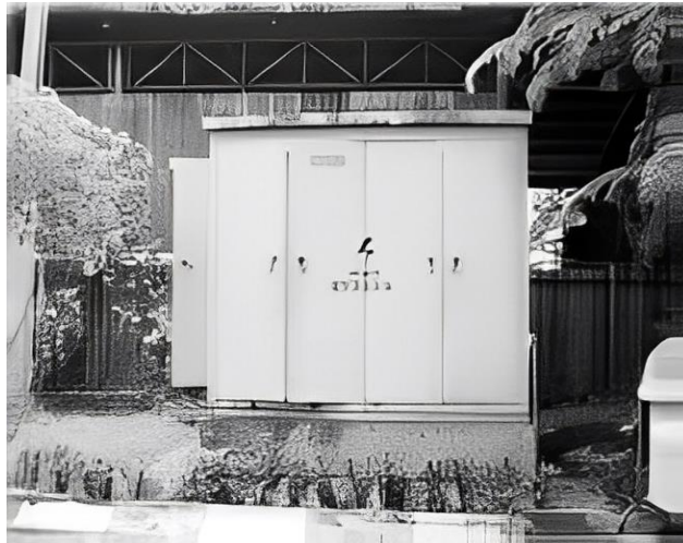
Gambar 2.12 Gardu Kios (PT. PLN (Persero) Buku 4, 2010)
