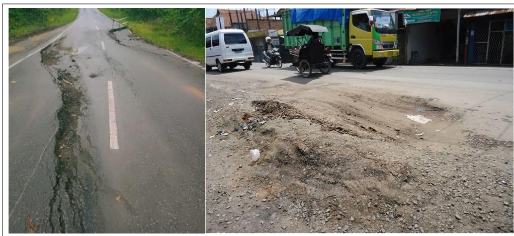
Gambar 5. Contoh kerusakan tanah dasar pada jalan aspal
