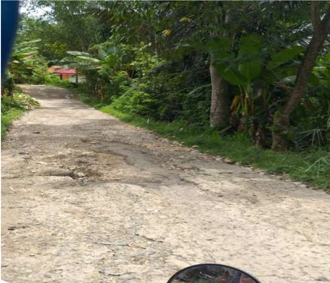
Gambar 6. Jalan ke Objek Wisata Palawa' yang rusak pada tahun 2022
